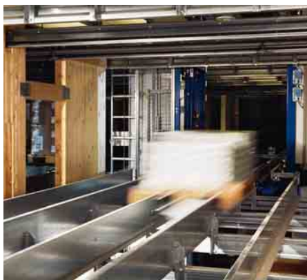
③ Von einem RBG mit Längs-Shuttle werden die Paletten – auch mehrfachtief – in die Fächer des Holzregals eingelagert.
