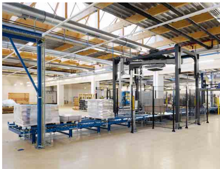
④ Die Ladungsträger durchlaufen entlang der Palettenfördertechnik eine automatische Konturenkontrolle, werden umreift, mit Folie umwickelt und schließlich etikettiert.
